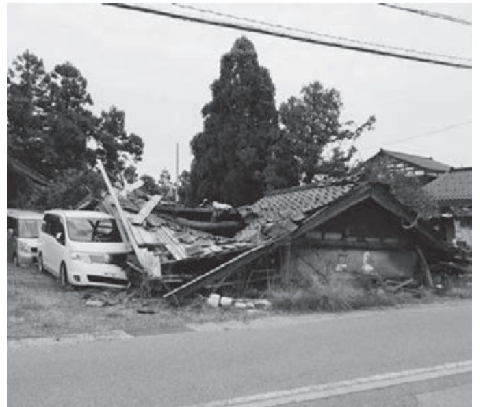
手つかずとなっている倒壊した家屋=現在の写真
