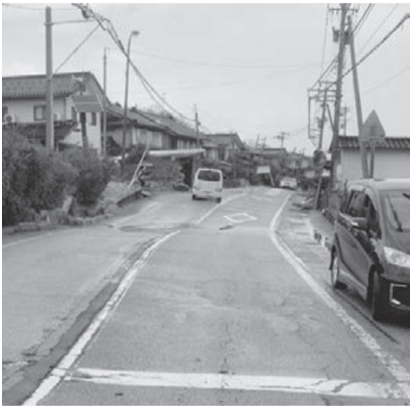
激しい道路の起伏＝被災当時の写真
