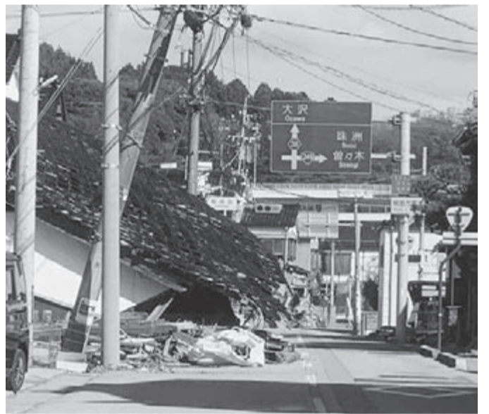
家屋が崩れ道路を塞いでいる＝被災当時の写真
