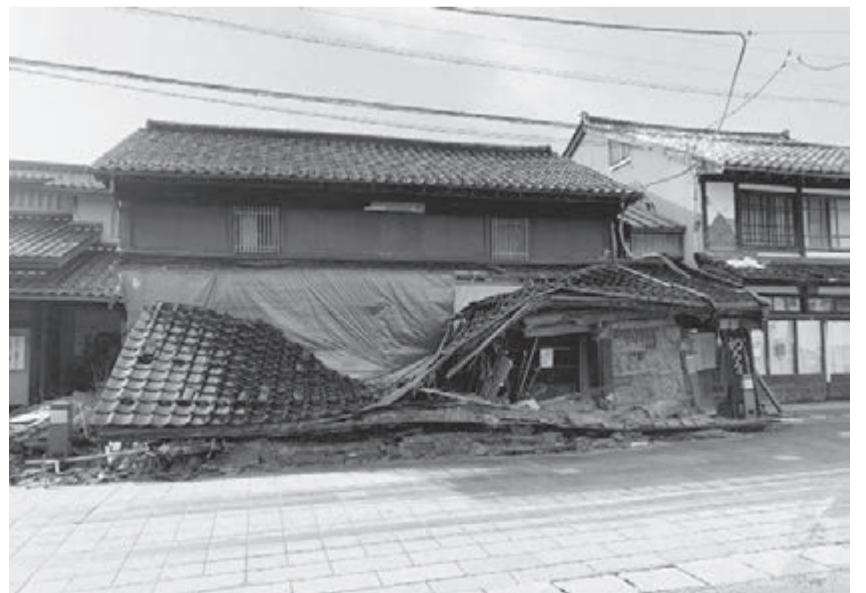
地震により倒壊した家屋＝被災当時の写真
